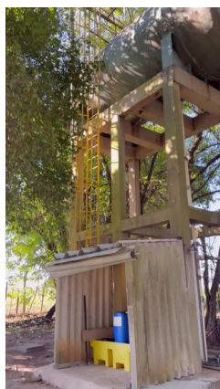
Abrigo do dosador de cloro, junto ao reservatório.
